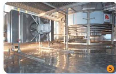
Double impingement crust freezing fan unit
